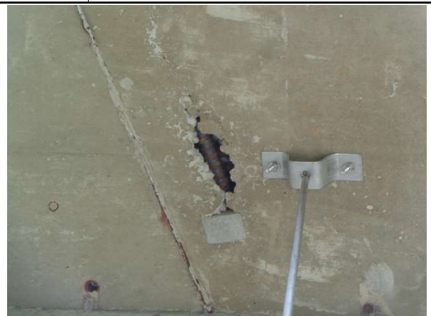
손상현황 • S3 철근노출(0.1m×0.1m) 원 인 • 시공시 다짐미흡, 거푸집 조기탈영 등 조치방안 • 단면보수+방청
