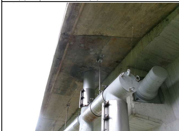
손상현황 • S5 박락(0.5m×0.4m) 원 인 • 다짐미흡, 열화 등 조치방안 • 단면보수
