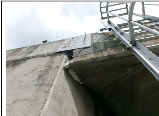
손상현황 • S1 파손(0.3m×0.5m) 원 인 • 외부충격 등 조치방안 • 단면보수
